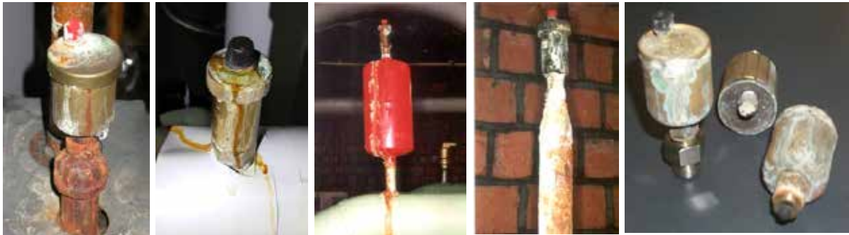
Beispiel für minderwertige Entlüfter, die aufgrund ihrer mangelhaften Konstruktion bald undicht werden
